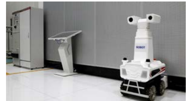
重庆彭水水电公司引进 5G+ 机器人智能巡检
